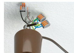
Aansluiting van verlichtingsarmaturen met fijnaderige overdracht
