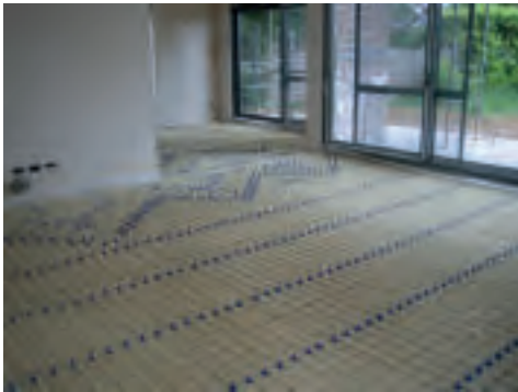
Refroidissement par le sol
