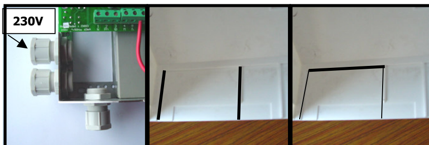
c) Kabel komt in de centrale via wartels
